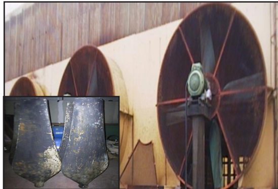
Damaged fan blades
